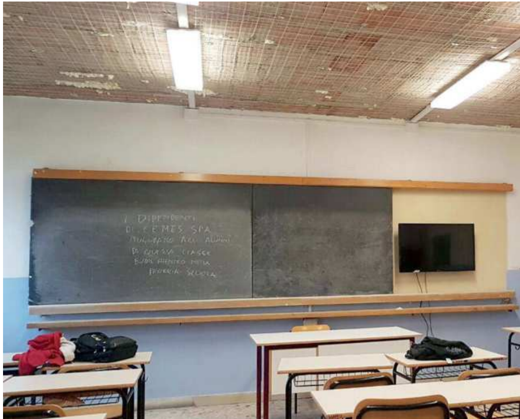
L'interno di un'aula della scuola Fermi nel 2017 all'epoca del crollo di parte del soffitto
